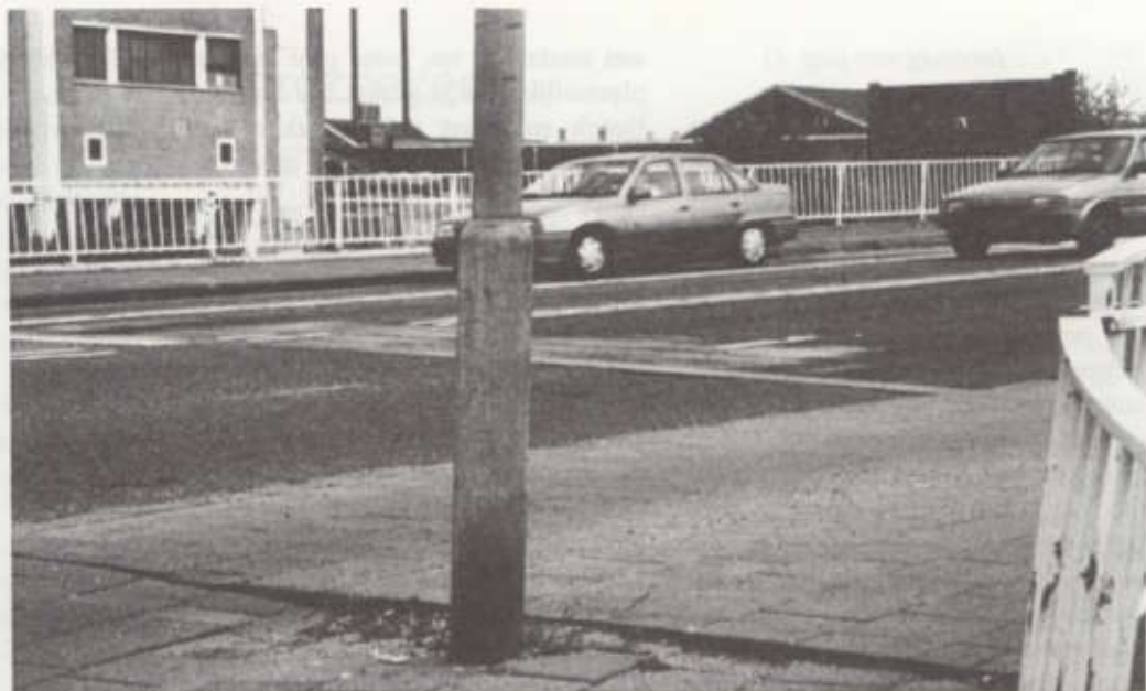
Beschadigd fietspad op Prinsenbrug (bij Droste)
