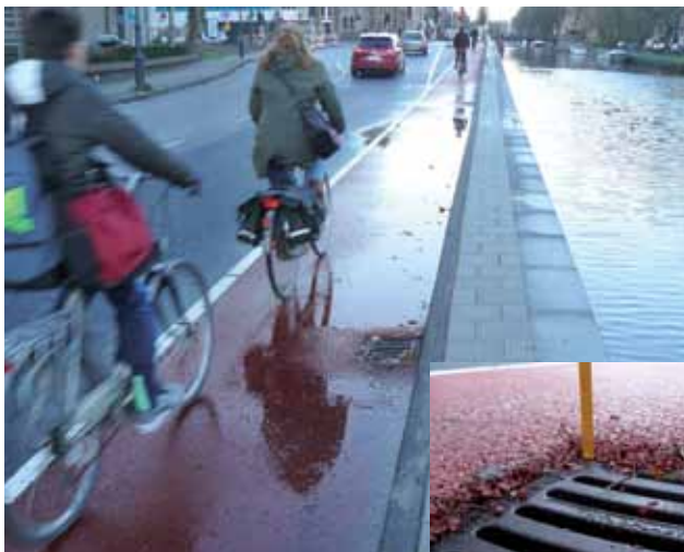
Rode fietsstrook staat onder water. Foto inzet: Slechte uitvoering, putdeksel ligt 4 cm diep.
