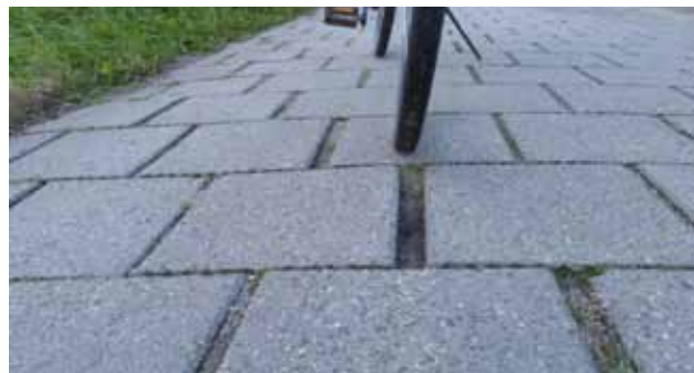
Leidsevaartweg: kierende tegels op het fietspad.
